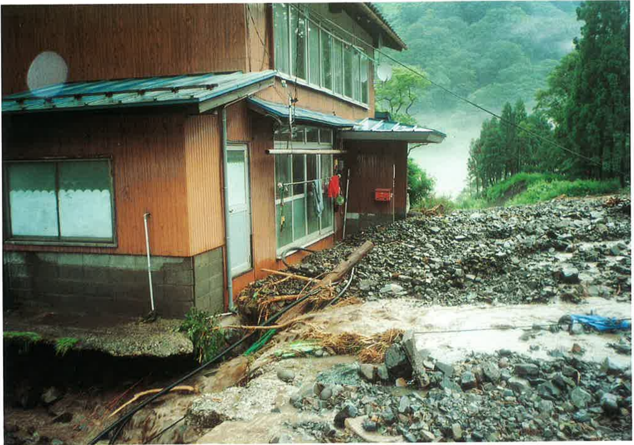
土石流により家屋床下流出
