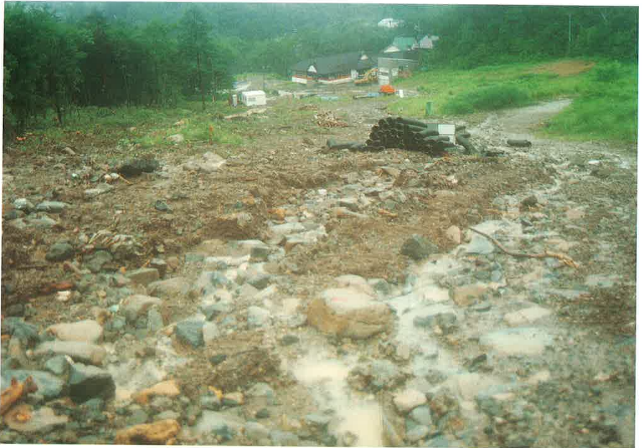
土石流で埋没した工事中の流路工
