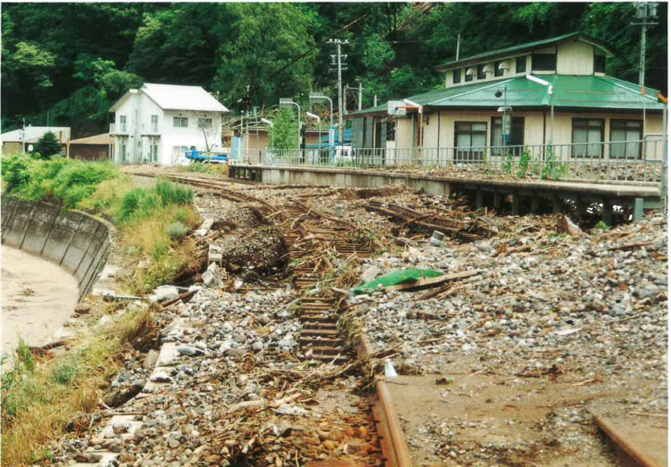
土石流によりJR大糸線被害
