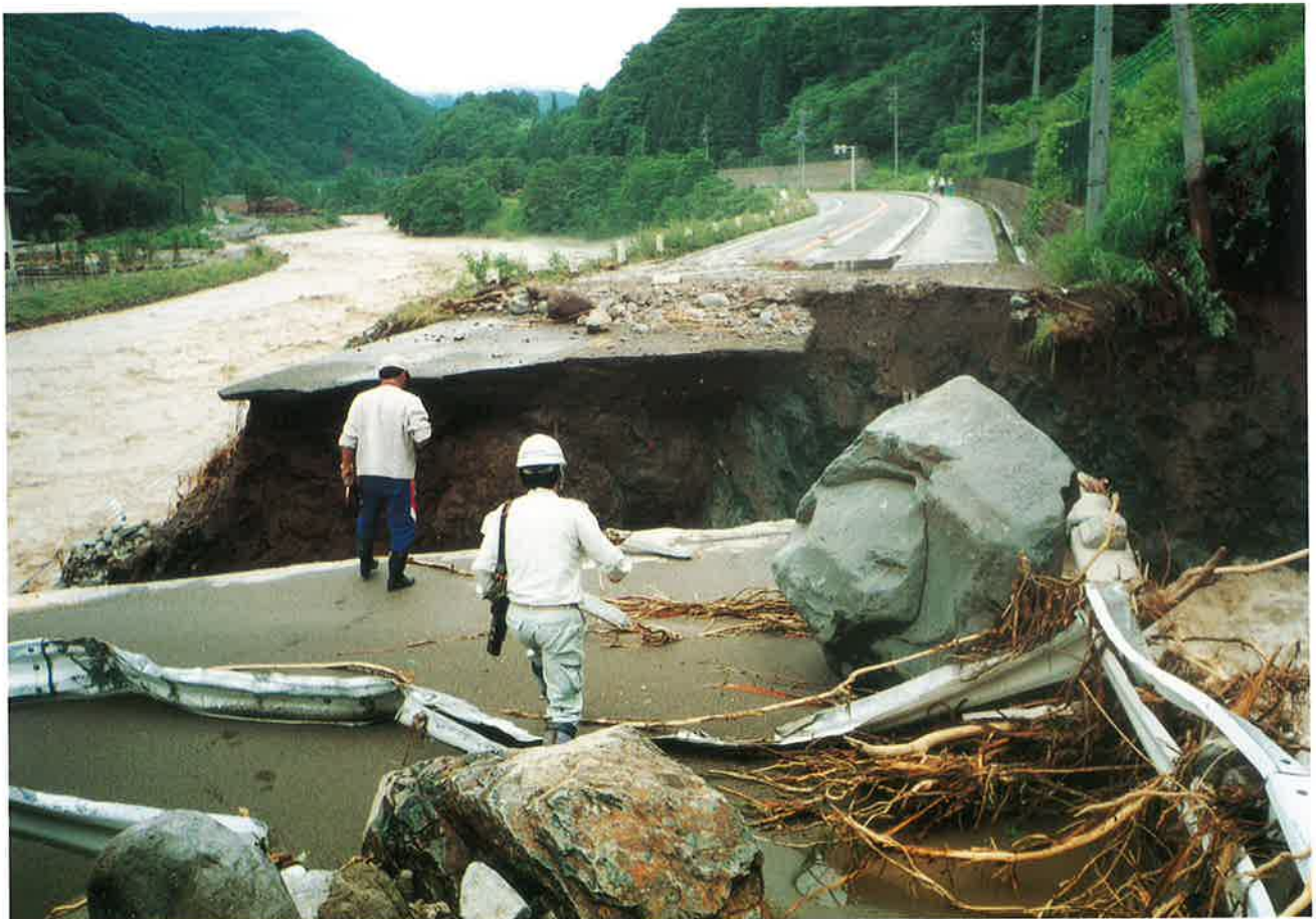
国道148号 橋梁流失
