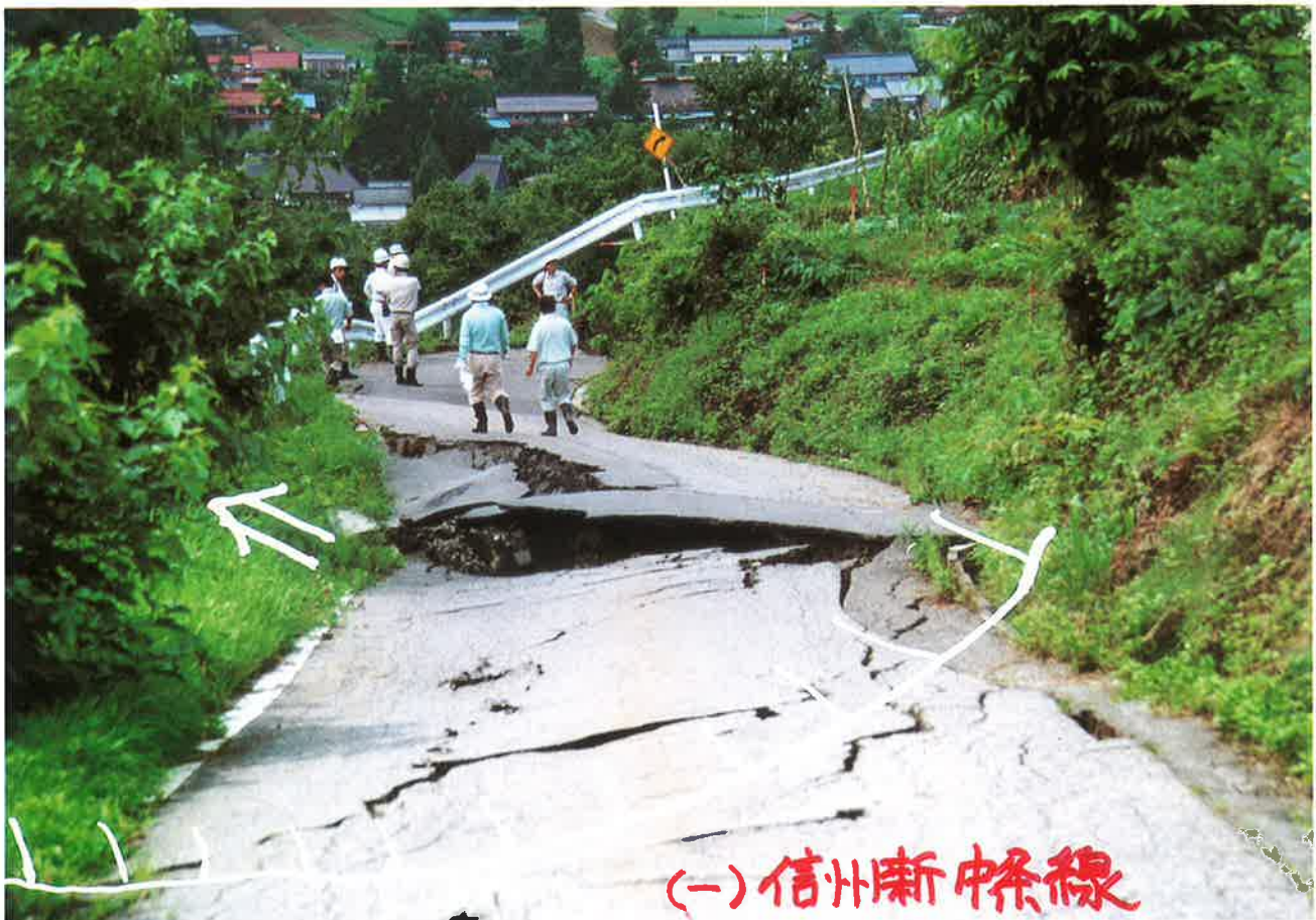
上記 地すべり頭部の県道のかん没状況
