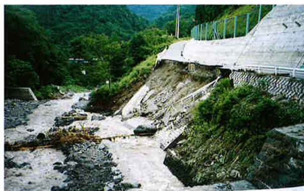
▲中流部護岸欠壊
