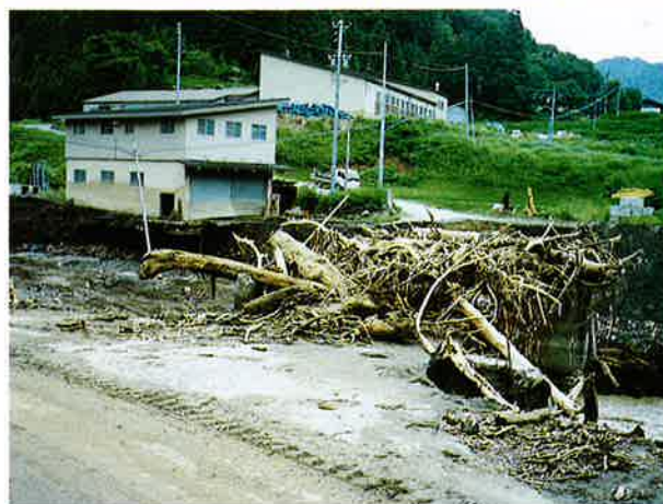
▲流失した村道橋
