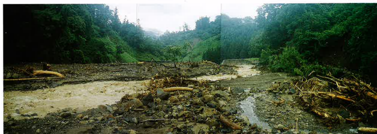
▲土石流により土砂が堆積した横根沢中流にある佐原砂防ダム
