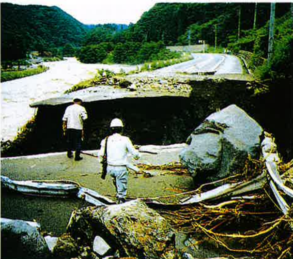
▲土石流が国道148号を直撃
