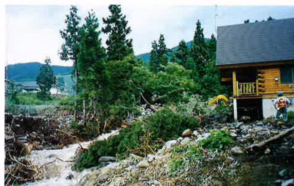
▲黒川沢上流部河川氾濫
