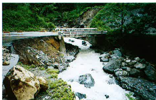
▲下流部護岸欠壊
