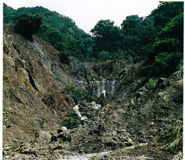
▲土石流により破壊した上流の砂防ダム
