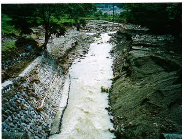
▲白井沢下流部の氾濫
