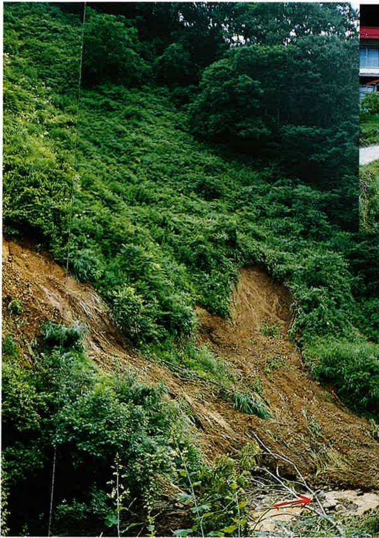
▲黒木沢上流部の法面崩壊
