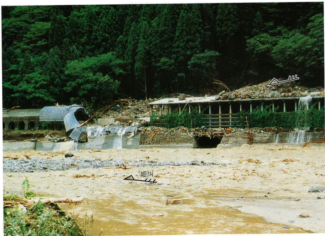
土石流によりJR大糸線損壊
