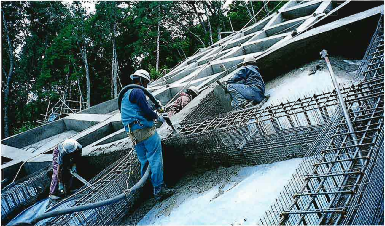
吹付枠工施工状況 組み立てられた鉄筋に合わせてモルタルが吹き付けられる。
