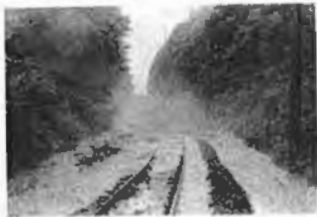
白馬村小谷近くでは道路にも土砂が崩れ不通
