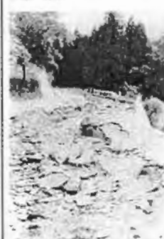
崩壊した道路一小谷村白馬駅前近
