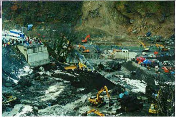
▲土石流災害 H8.12/7
