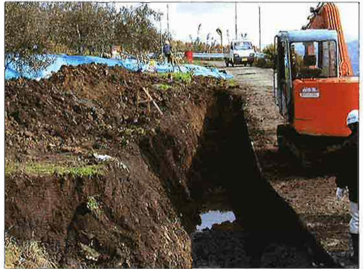
頭部亀裂位置の湧水状況
