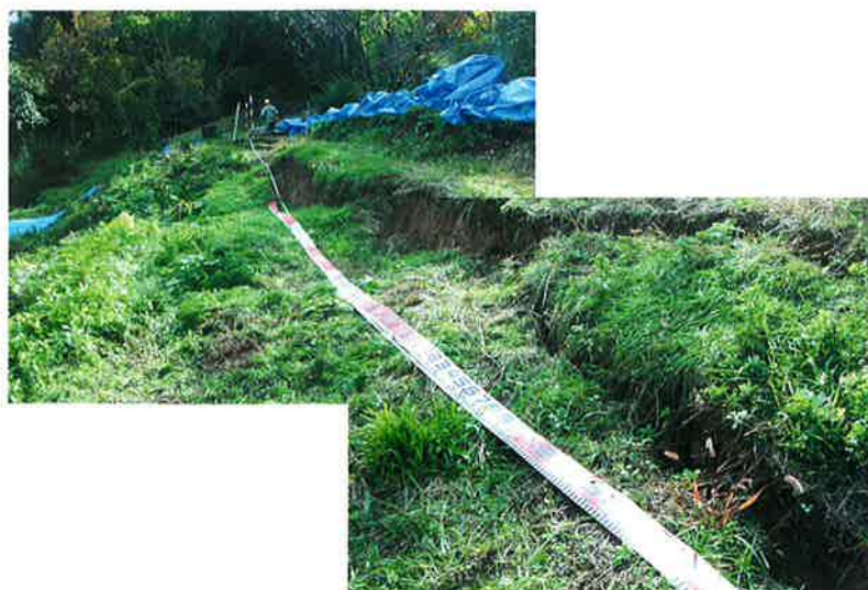
浅川 地すべりにより生じた段差
