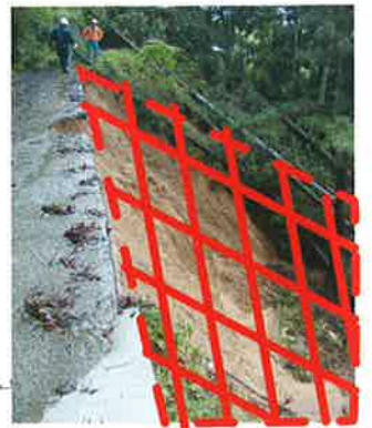
⑤ 上流市道路肩が決壊(法枠)
