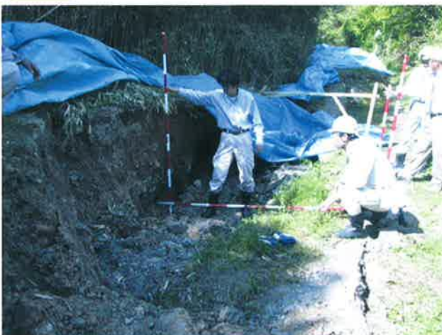
西田沢 地すべりによって大きな段差が生じた
