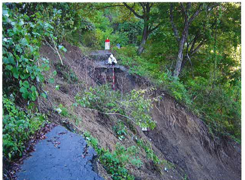
地すべりにより村道が崩壊
