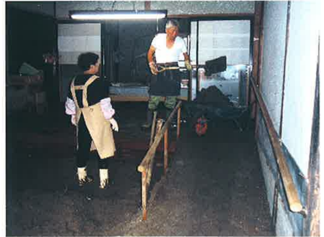
新引沢 民家に入った土砂の撤去状況
