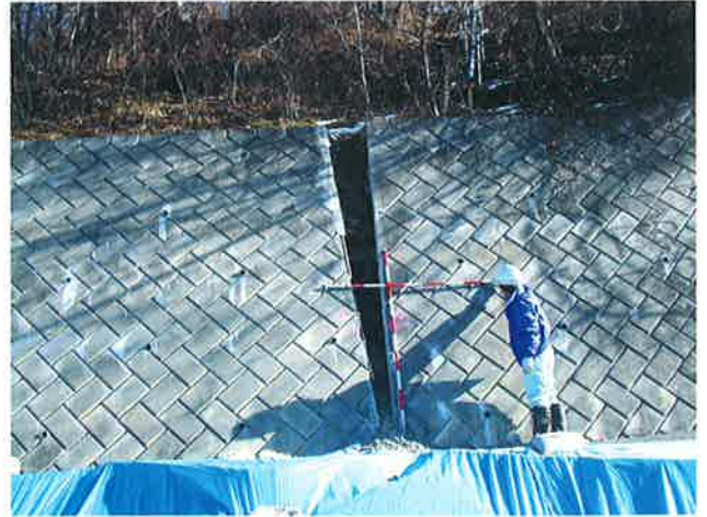
原 ブロック積みに変状が発生
