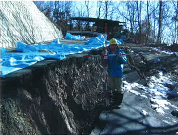
原 12月に発生した地すべり
