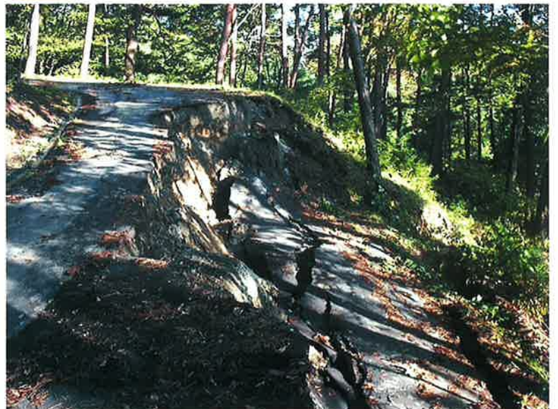
地すべりにより村道が崩壊
