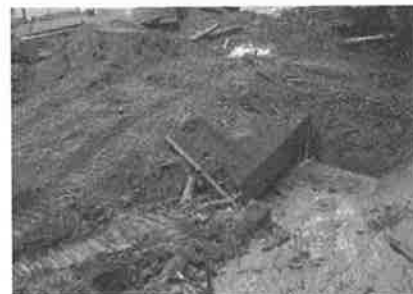
写真-36 ボックスカルバートの閉塞
