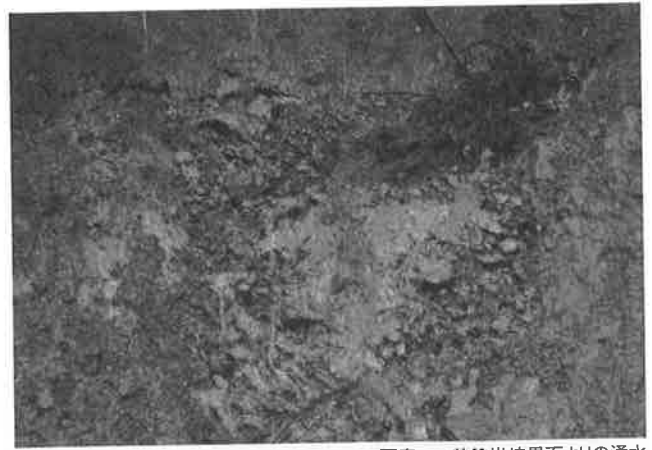
写真-2 基盤岩境界面よりの湧水
