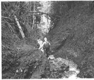
写真-20 溪岸浸食
