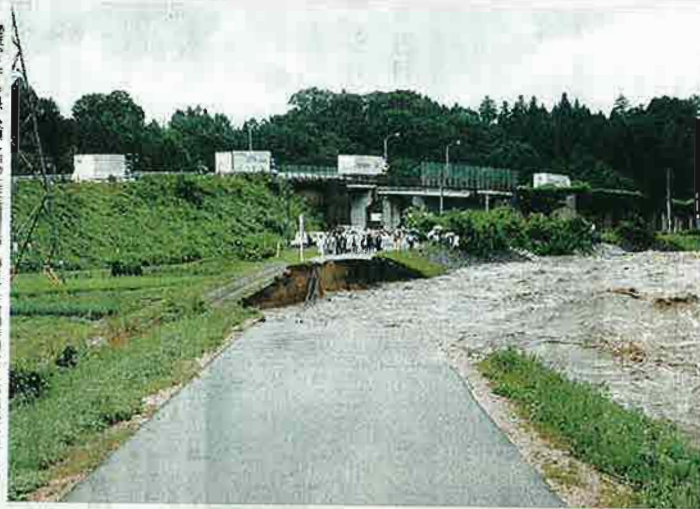
濁流がさらわれ、決壊した天竜川堤防。19日午前10時頃、上伊那郡箕輪町松島
