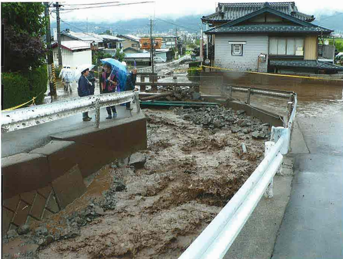
中ノ沢川(北真志野)土石流による県道浸水状況
