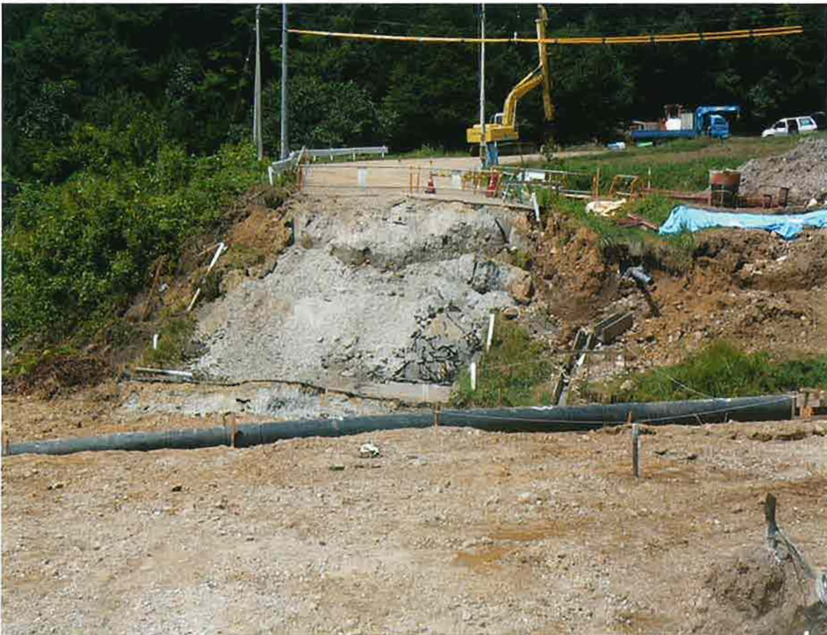
地すべりによる道路の滑落
