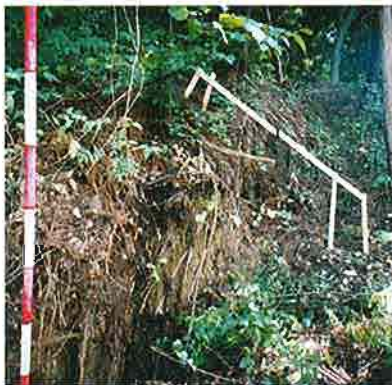
サイドの亀裂
