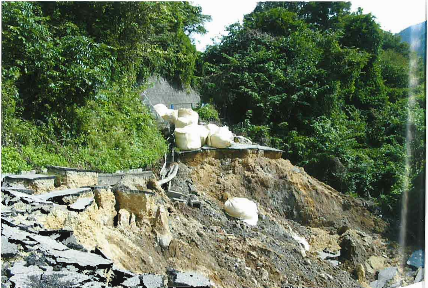
佐久市(駒込)地すべり発生状況(H18.9.29)
