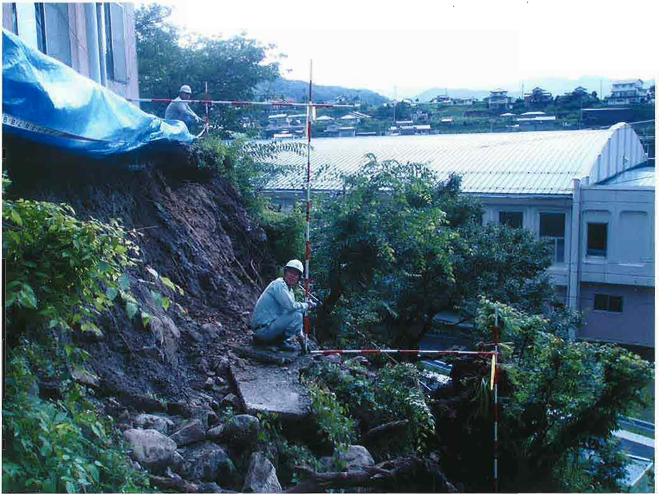
諸町 がけ崩れ発生状況
