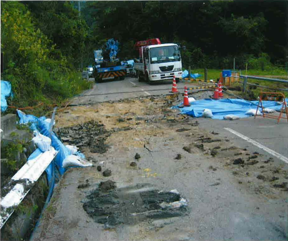
地すべりによる被害状況
