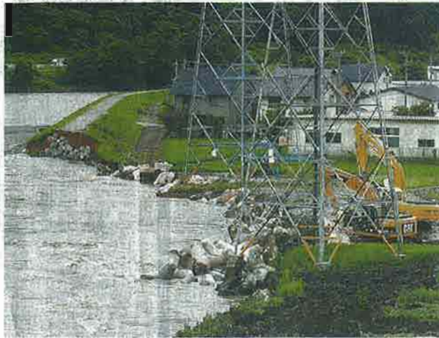
重機で旧旧作兼毛急ぐ試練町松島の天竜川堤防決壊現場—20日午前8時半
