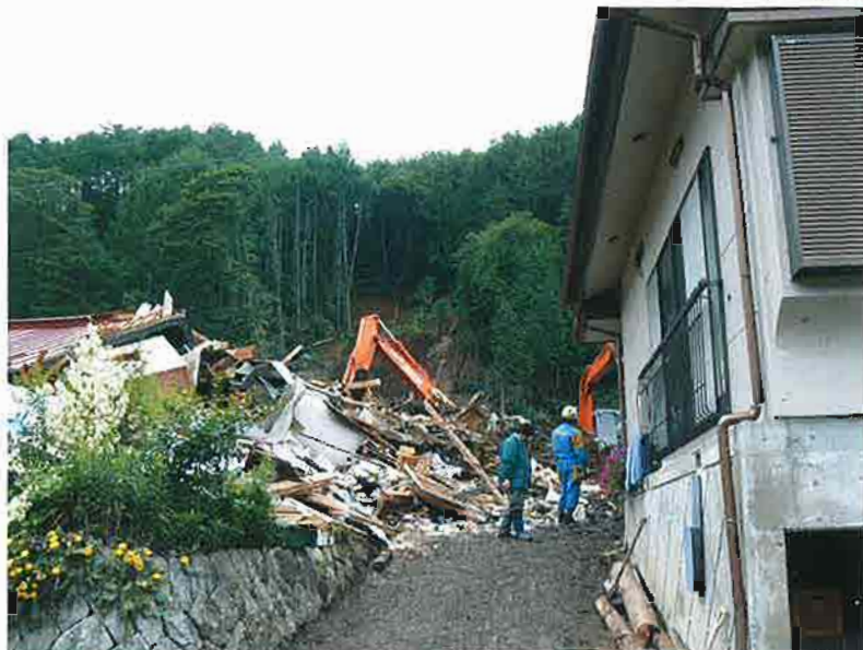
倒壊した家屋
