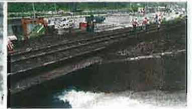
鐵路を覆った土砂が除去された塩原市 木曾平沢のJR中央西線＝20日午後2時10分
