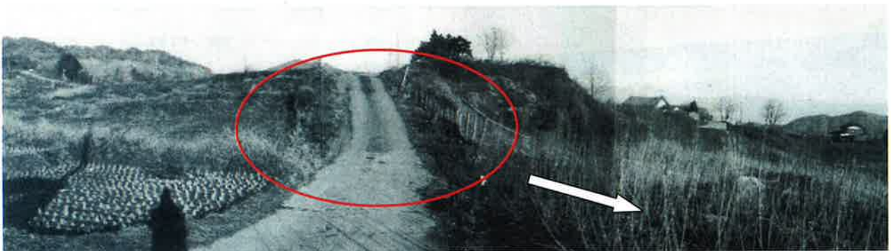
○印の市道が年々陥没し右下方に移動（撮影年不明）
