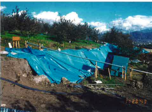
地すべり頭部の滑落崖
