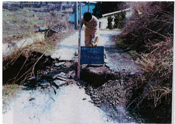
村道に発生した段差、亀裂
