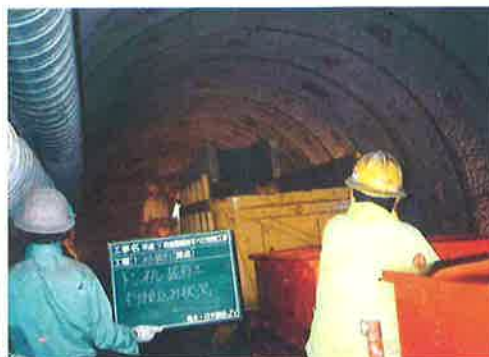
NATM工法による 排水トンネル施工状況 （H10 倉下 白馬村）
