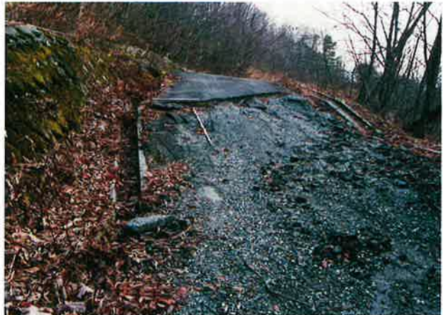
道路に発生した段差
