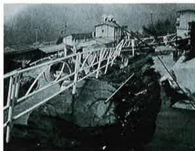
上島地区の被災状況
