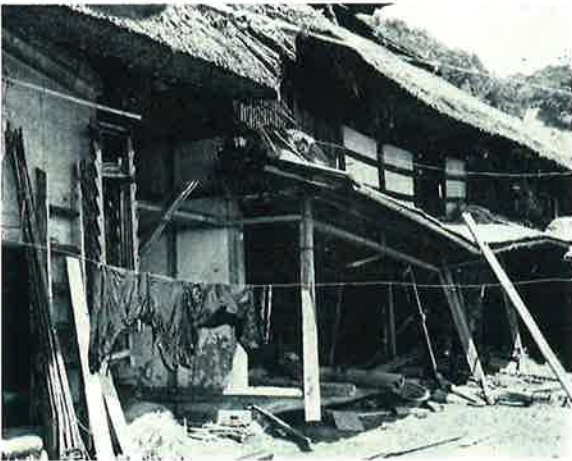
地すべりにより倒壊寸前の家屋
