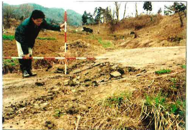
道路に発生した段差（撮影年不明）
