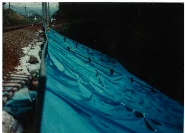
JR 信越線 (当時) に被害発生
