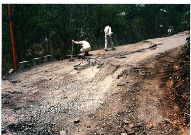
村道に発生した段差
