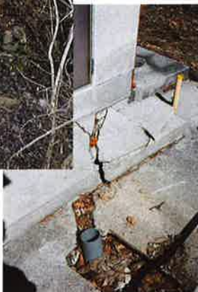
被災状況 （家屋に発生した亀裂）
