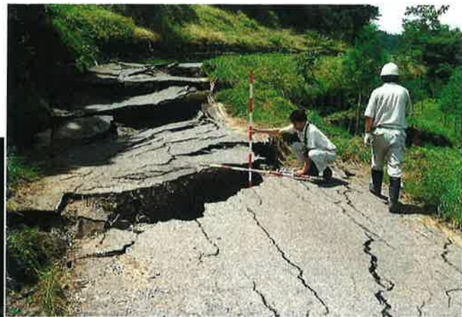
中条村 なるやま 成山地すべり (県道の段差状況)
