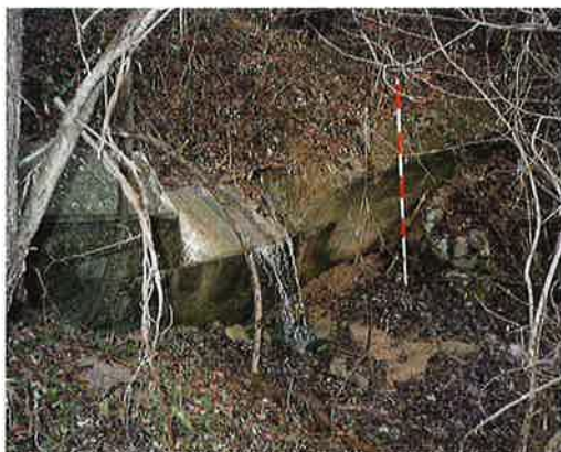
被災状況（転倒した谷止工）
