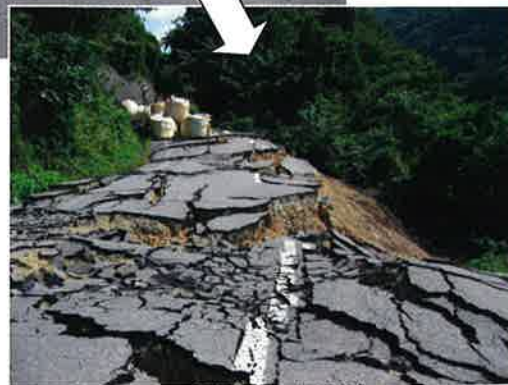
寸断された道路
