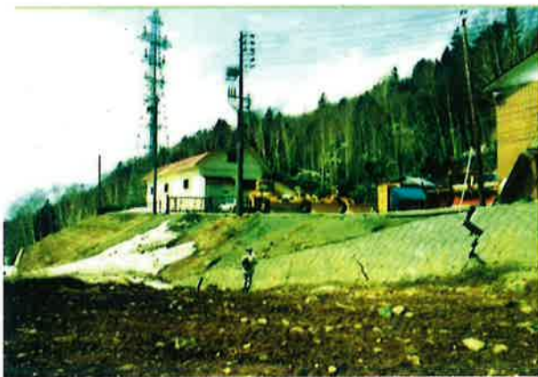
スキー場の駐車場に発生した亀裂 (地すべり頭部)
