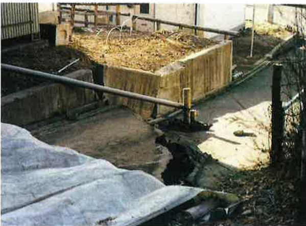
道路の段差、亀裂状況
