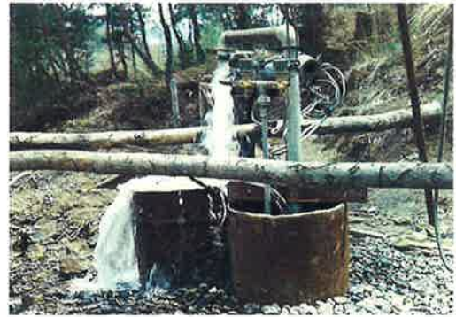
深井戸工頭部の排水ポンプ (S42 茶臼山 長野市)
