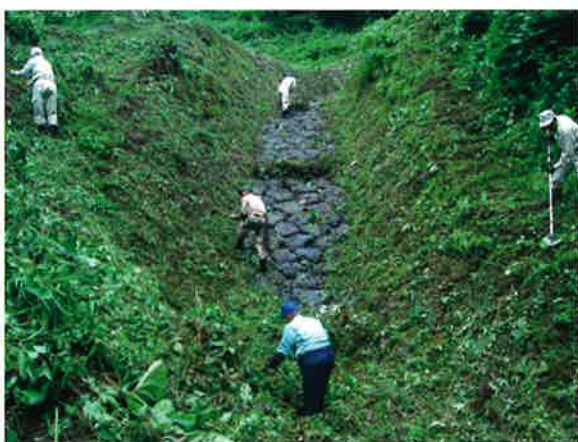
施設の管理（草刈り）（味大豆地すべり） 明治時代につくられた施設の草木の除去などの管理は、建設当時から地元の皆様により行われております。
