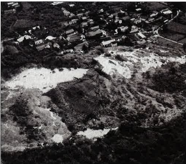
被災状況（白く光って見えるのは噴出した地下水と連日の降雨による水たまり）
