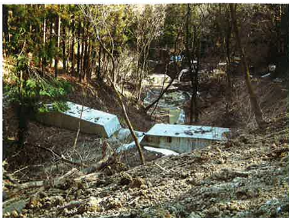
平成16年台風23号による土石流を止めた砂防えん堤（生坂村）
