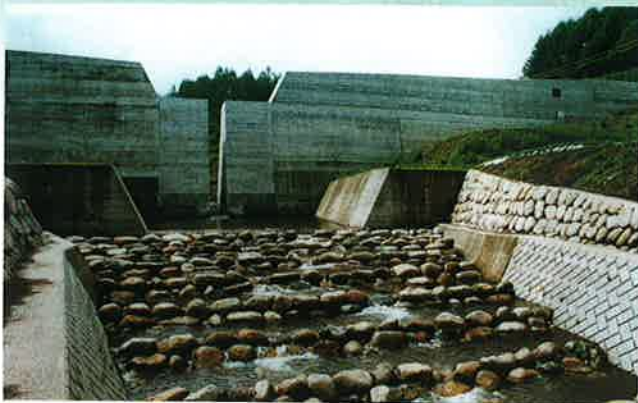
(コンクリートスリット) (前川 川上村原)
