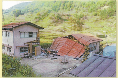
地すべりにより分断破壊された 稲丘東区農業振興センター
