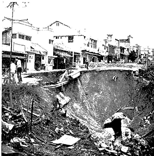
道路にあいた大穴 (2級国道飯田豊橋線) 飯田市長船町
