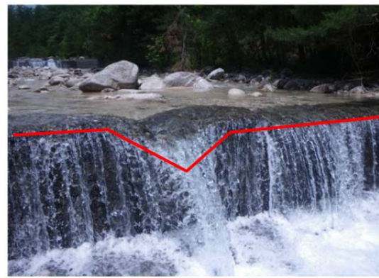
② 砂防堰堤、床固工の天端摩耗
