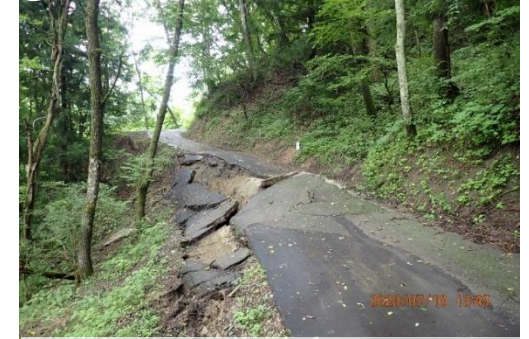
【被害状況等】村道崩落
