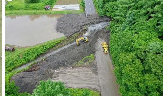
【被害状況等】県道へ土砂流出
