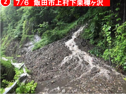
【被害状況等】林道通行止め
