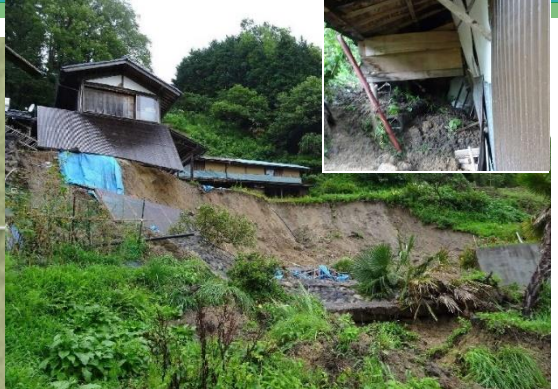
【被害状況等】人家1戸一部損壊、3世帯自主避難
