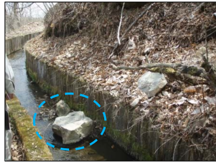
落石による通水阻害の懸念 軽井沢町：御影用水地区
