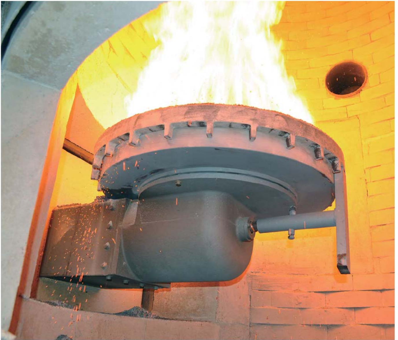
バイオマスボイラ燃焼炉の内部
