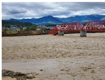
(崩落した上田電鉄別所線の鉄橋)
