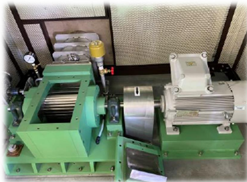
内部のクロスフロー水車
