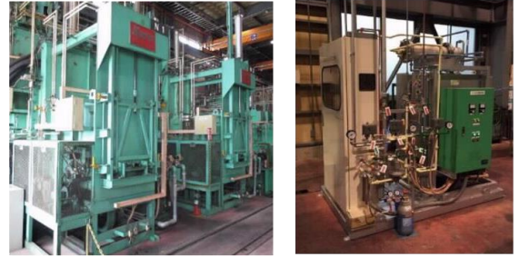
「M-NCプロセス」窒化処理設備、ガス制御装置
