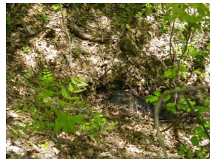
堤体法尻漏水状況
