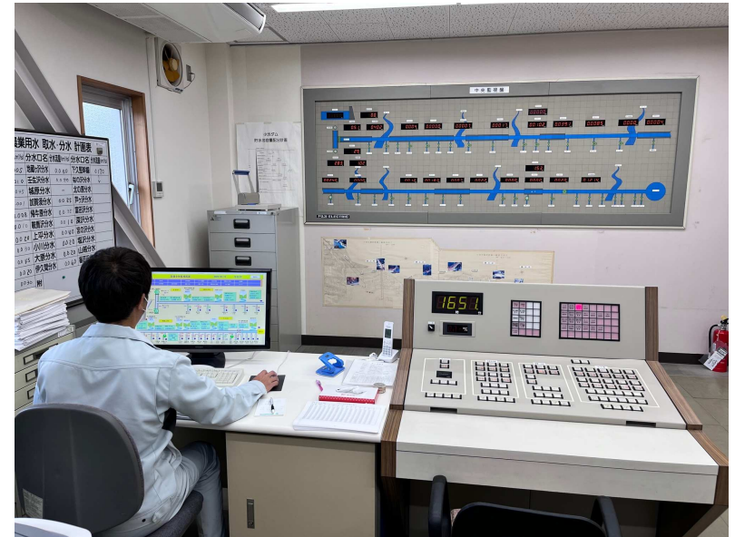
中央管理室での遠隔監視・操作
