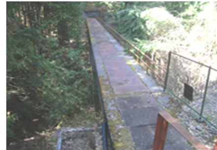
劣化が進んだ水路橋
