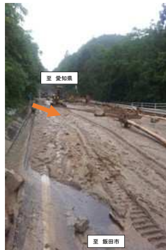
【国道への土砂流出状況】
