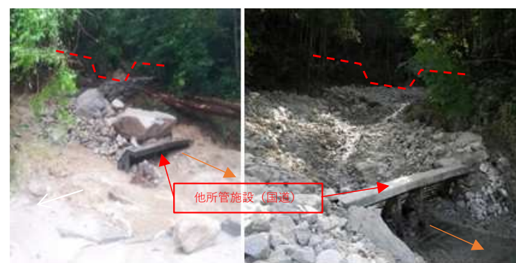
(被災直後) (応急排土後) 国道直上部の状況 (No1床固工計画地)
