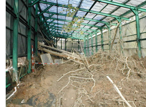
倒木発生状況
