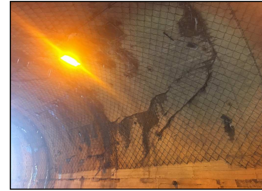
旧道トンネルの劣化状況
