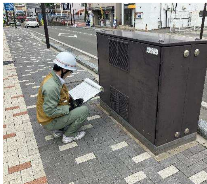
電力会社による点検
