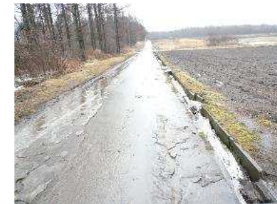
排水路の損壊
