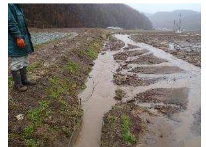
排水路の損壊による畑の冠水
