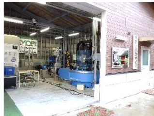
小水力発電施設
