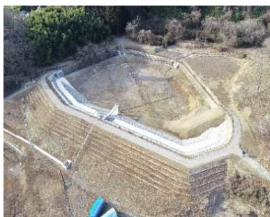
防災工事等を実施したため池 (上田市西塩田地区 不動池)
