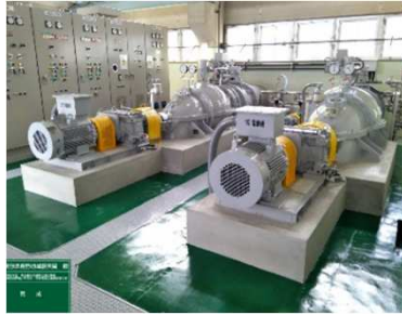
整備したポンプ設備 (西寺尾第2排水機場)
