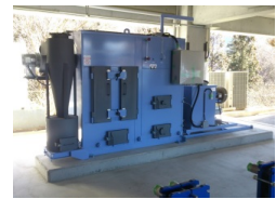
ペレットボイラー(伊那市)
