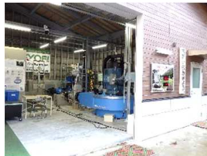
小水力発電施設
