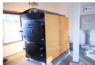
薪ボイラ（安曇野市）
