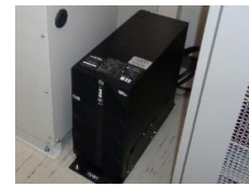
防災行政無線UPS
