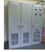
防災行政無線地上系電源設備
