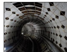
堰水被害対策用の排水トンネル（梓川右岸地区）
