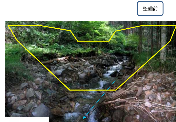
樽沢流域の整備状況【谷止工】
