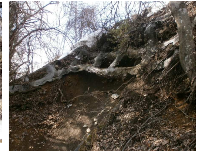
【既設法枠工の劣化状況(脚部浸食中抜け)】
