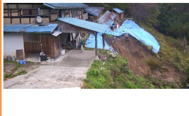
家屋の被災状況
