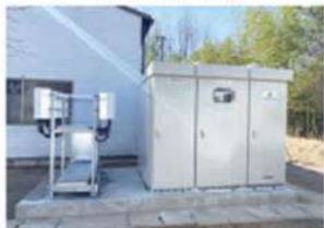
飯田市 N社 PCS+高圧変圧器
