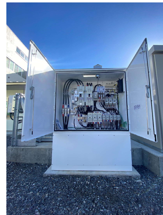
切替盤 : 鶴田電機製
