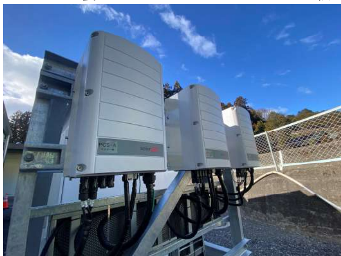
SolarEdge製 : SE17.5K-JP3台
