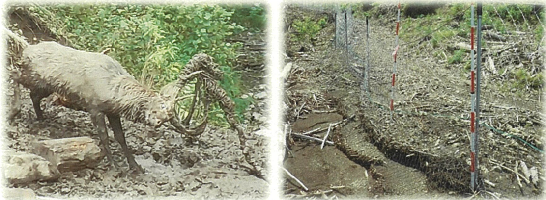
(写真-2) ネットが角に絡まり暴れる雄ジカ (写真-3) 堆積土砂がネットを緊張する様子
