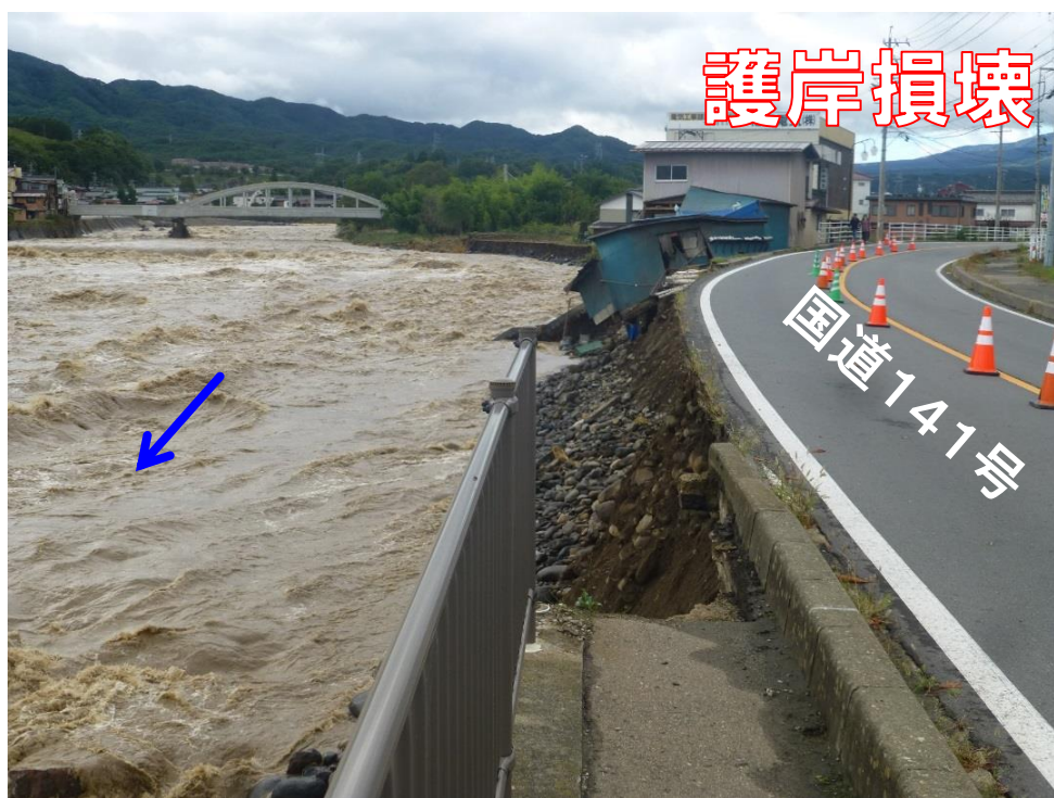
国道141号が通行規制
