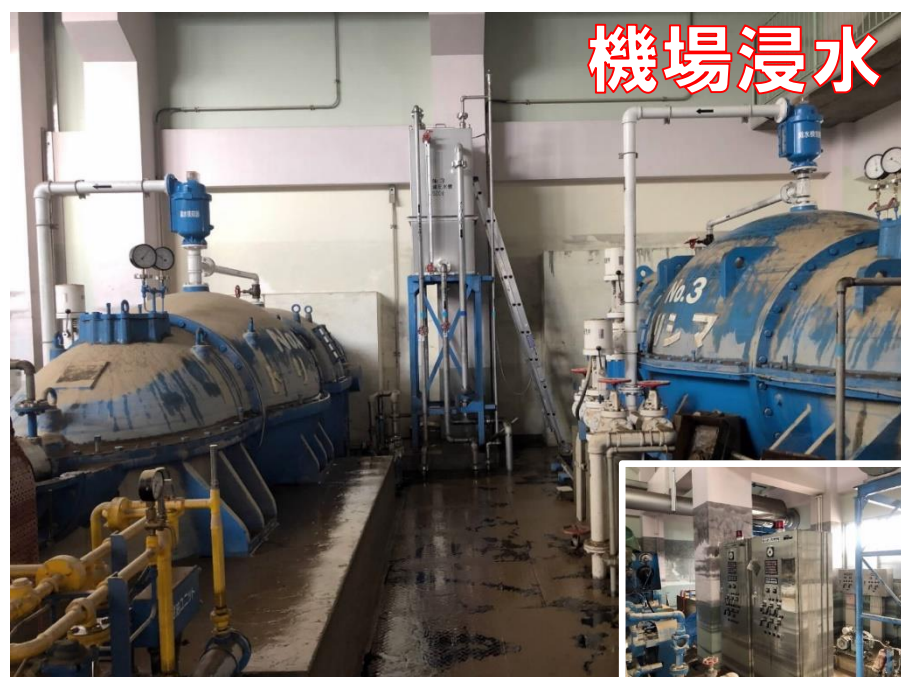
排水機場が浸水し稼働不能
