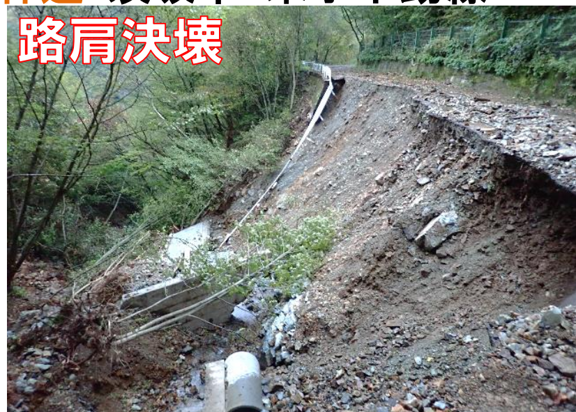
豪雨により路肩が決壊
