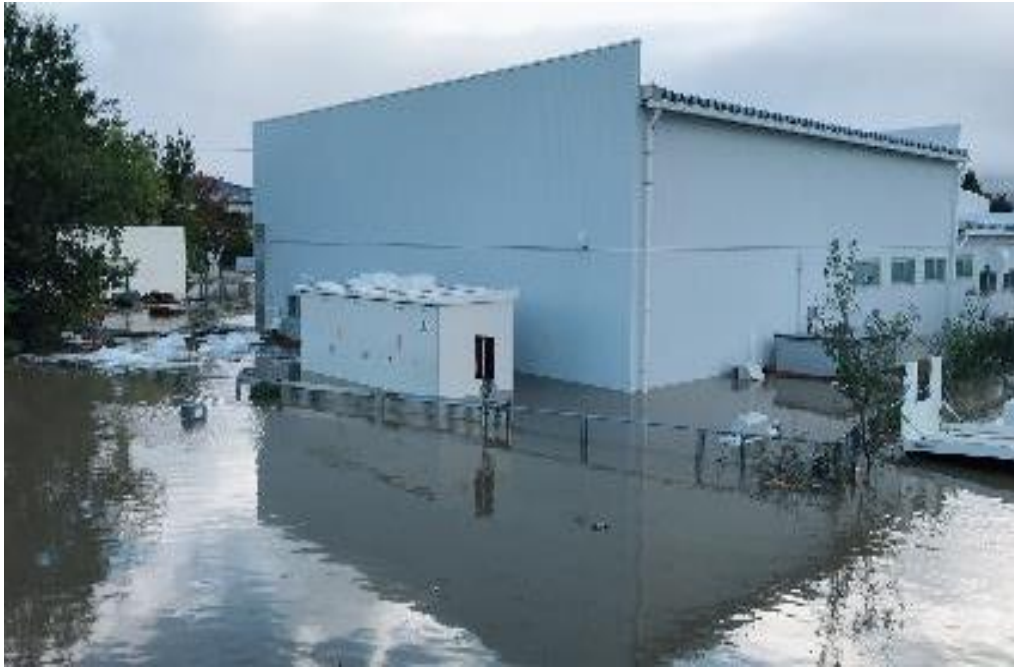
工場浸水（外観）
