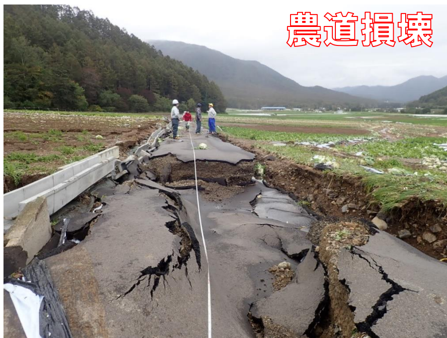
農道が損壊し通行不能
