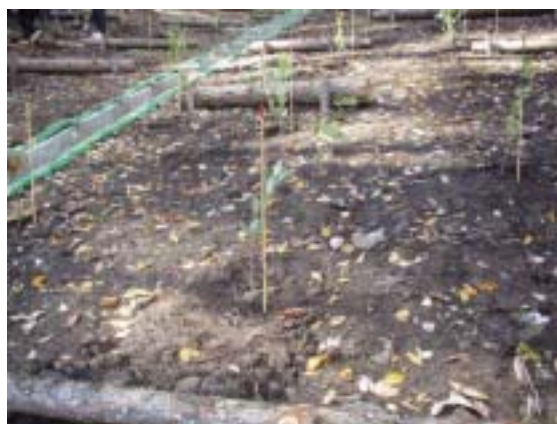
【崩壊地における植栽の実施例】 植栽と併せて、周辺森林で間伐した伐採木を利用した筋工を実施しています(岡谷市小田井沢)
