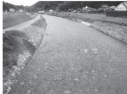
図8 平坦化した河道(耕地村橋区間)
