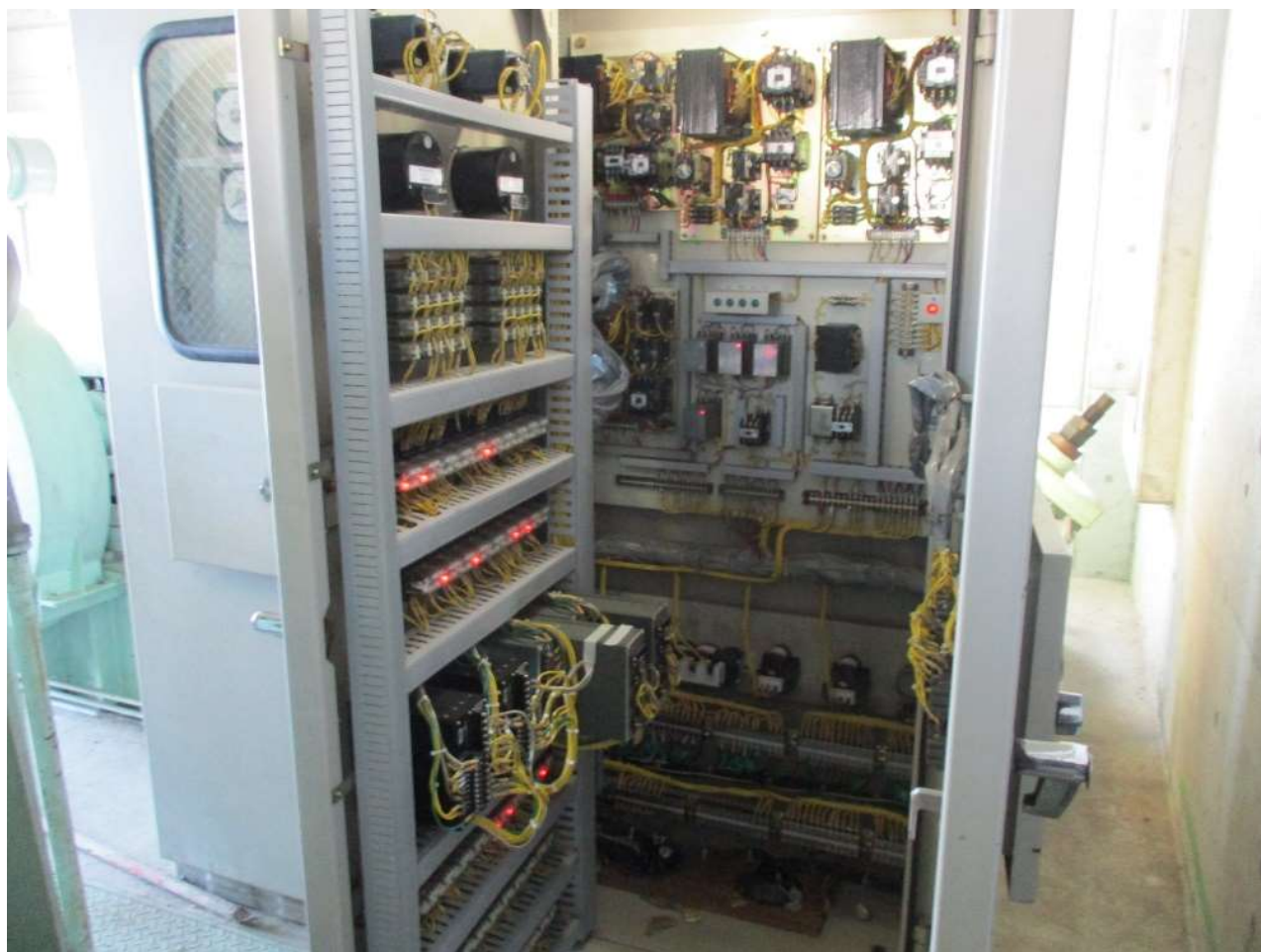
機側操作盤内部
