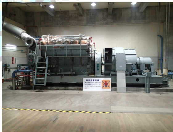
非常用発電施設
