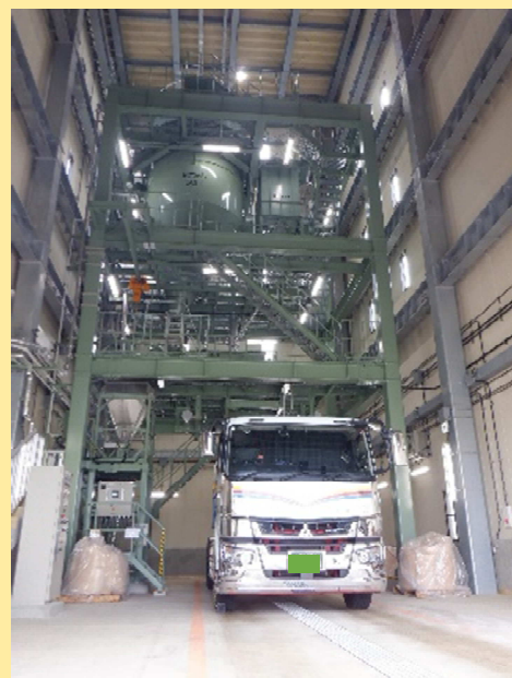
焼却灰搬出ホッパ棟（棟内）
