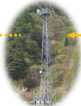
ダム管理棟堤体観測装置
