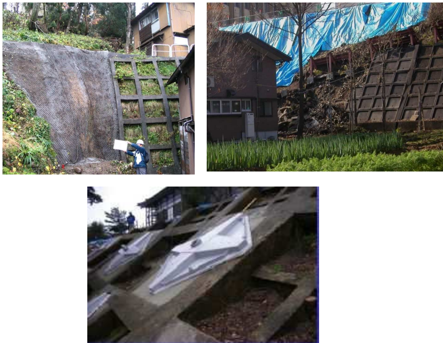
写 3-12 のり面保護工の変状の例
