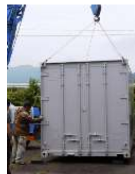
【海上コンテナ冷蔵庫設置】
