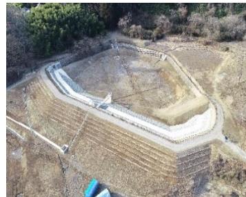
防災工事等を実施したため池(上田市西塩田地区 不動池)
