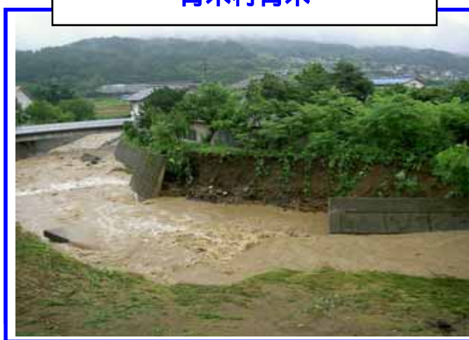
護岸決壊状況(浦野川) 青木村青木
