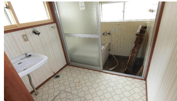
脱衣所・浴室
